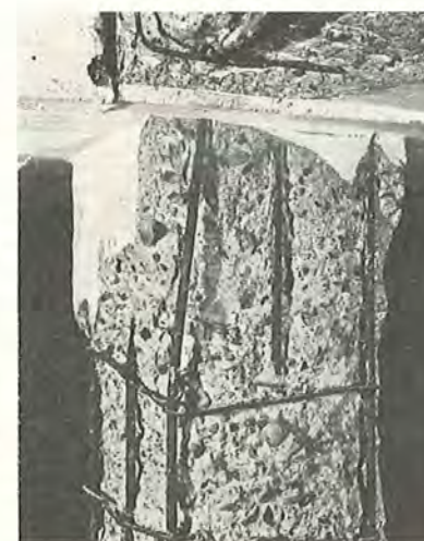
Fig. 5. Typiske afskalninger på en bærende søjle under et svømmebassin. Altså et tilfælde hvor sådanne skader er iagttaget inde i en bygning, men vel at mærke på grund af de særligt fugtige forhold.
