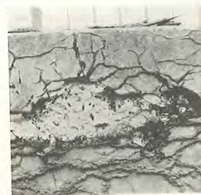
Fig. 33. Map-cracking i forbindelse med afskalning forårsaget af skadelige alkalikiselreaktioner i den pågældende beton.
