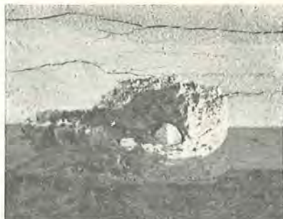
Fig. 11. Meget udpræget springerdannelse i en rækværkshjelke på en bro. Iovrigt udviser den pågældende konstruktionsdel meget alvorlige revnedannelser, der kunne tyde på ødelæggelser af betonen som følge af skadelige alkalikislerreaktioner. En sådan beskadiget rækværkshjelke kan ikke istandsættes, men må borthugges og fornyes.
