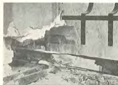
Fig. 3 og 4. Skitse og foto af udpræget og ikke ualmindelig rusttæring af bærende profiljern i altankonstruktion. Nedsivende vand har i dette grelle tilfælde helt borttøret profiljernet i krop.
