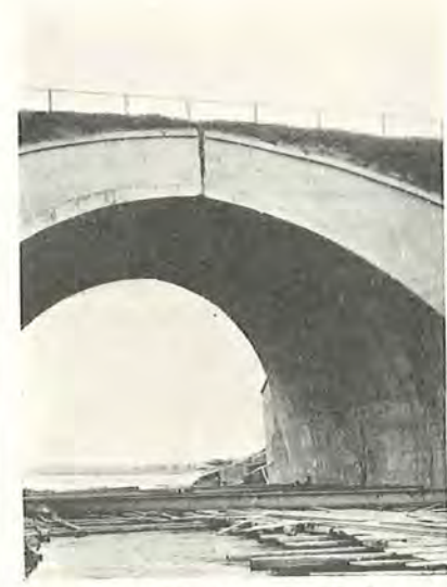
Fig. 35. Trækbrud i jernbetonbuebro.
