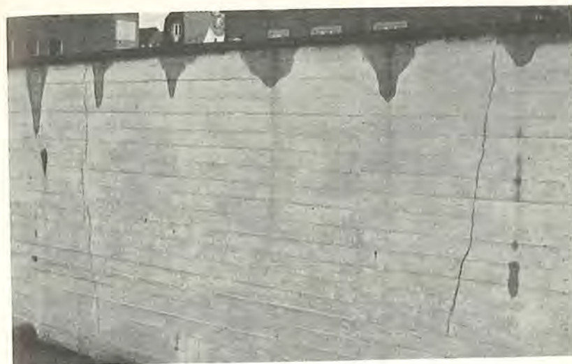
Fig. 26. To typiske svindrevner i en støttemur. Afstanden mellem revnerne er ca. 4 m.
