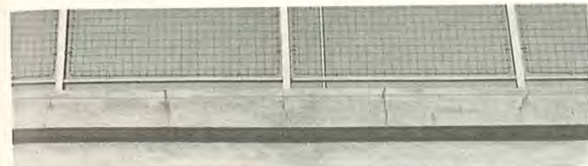
Fig. 38. Revner i rækværksbjælken over en mellemunderstøtning af en kontinuerlig jernbetonpladebro. Revnerne skyldes en for svag armering af dækstenen.
