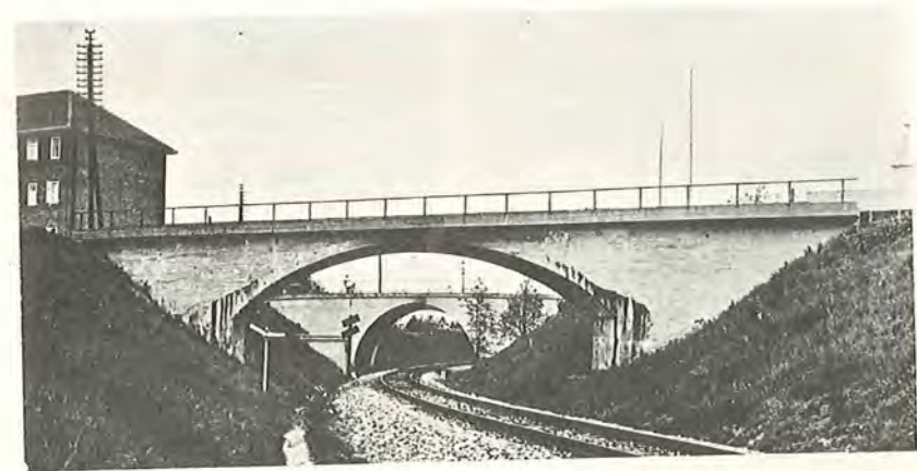
Fig. 25. Typiske utætheder i støbeskellene mellem jernbetonbue og fløjmur.
