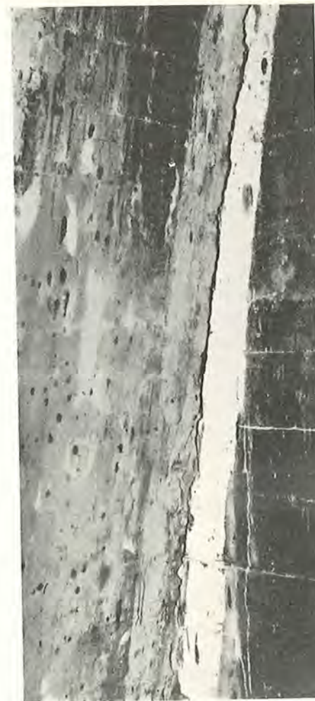
Fig. 40. Svære hjørnerrevner i klapkælderen i Oddesundbroen.
