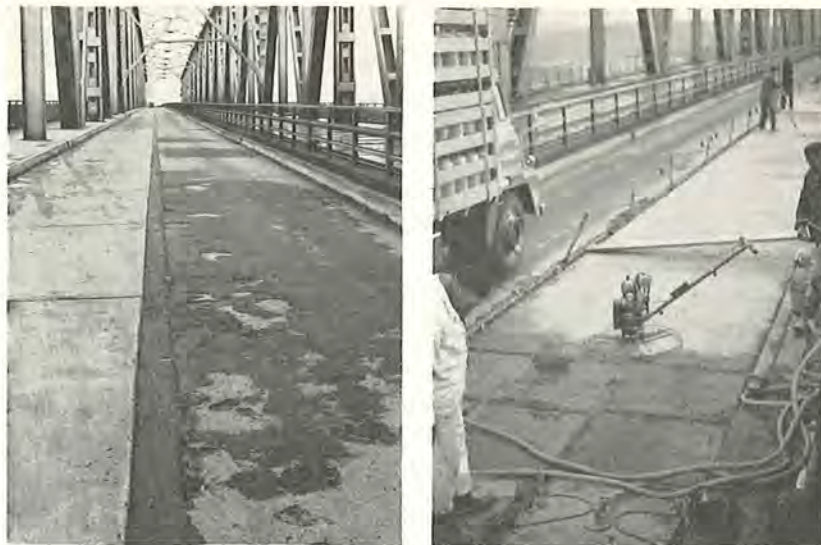
Fig. 115. Et ødelagt parti af kørebanen på Lillebæltsbroen. Beskadigelserne er søgt midlertidigt afhjulpet ved udlægning af asfalt, der imidlertid ikke viste sig holdbar men snarere fremmende for den videre nedbrydning af den underliggende beton. Den venstre side af kørebanen er istandsat ved hjælp af vacuumbeton og har været i brug nogen tid.
