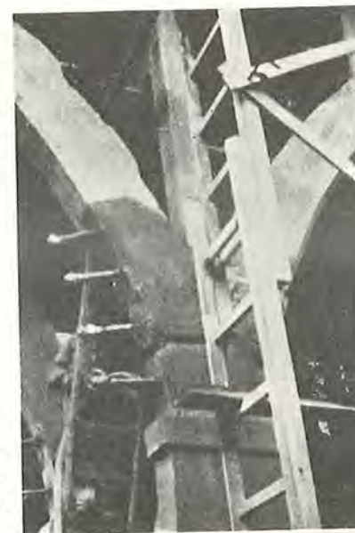
Fig. 16. Porøs og af indsuget vand beskadiget vederlagsparti af en jernbetonbue. Istandsættelse finder sted ved hjælp af injektion med cement. Se afsnit III.
