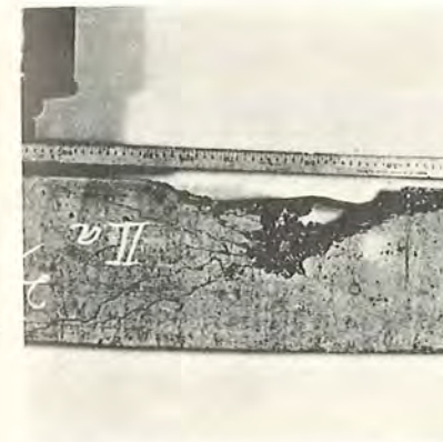
Fig. 36. Trykbrud i jernbetonprøvebjælke.
