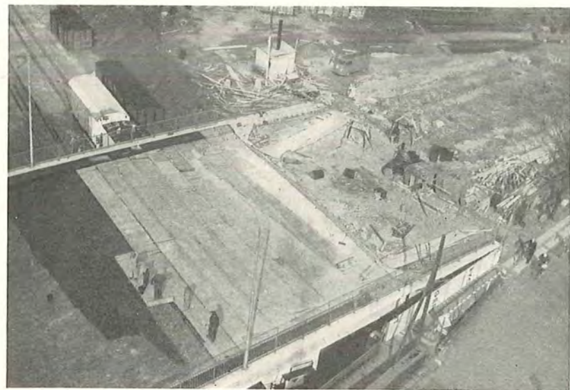
Fig. 99. Oversigtsbillede visende en del af det med bitumenplader isolerede brodæk.
